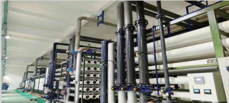
特殊廢水處理系統
