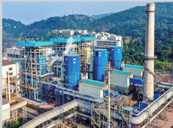
重慶鋼鐵自發電設備
